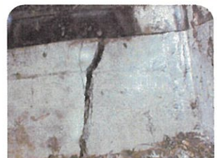
基礎のひび割れ
